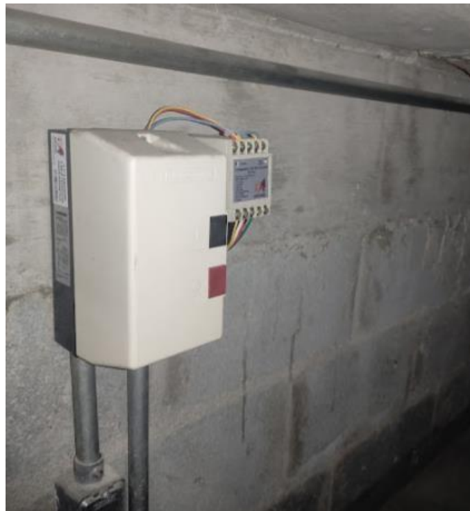
Figura 9 - Acionador manual e módulo de acionamento da bomba de Incêndio
